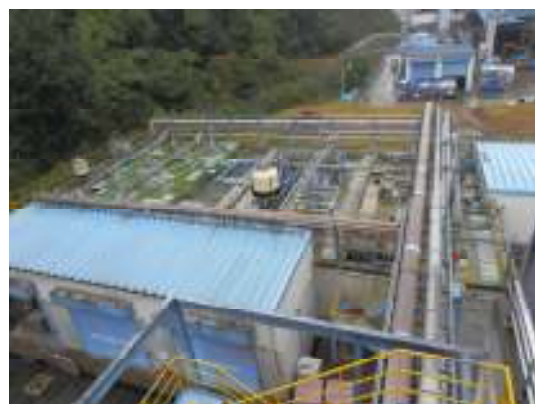
排水処理施設
