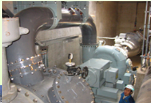
【水力発電設備】
