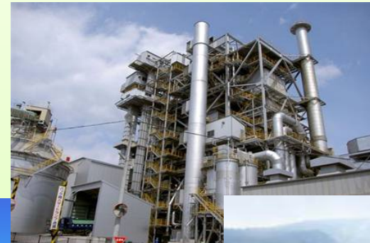
【バイオマス発電設備】
