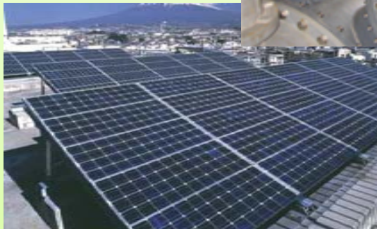
【太陽光発電設備】
