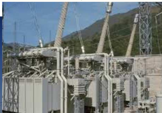
超高圧の 変電所
