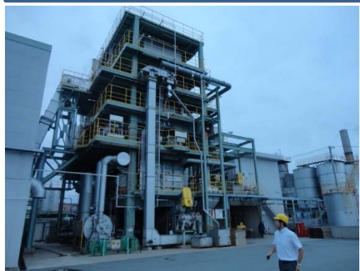
バイオマスボイラー
