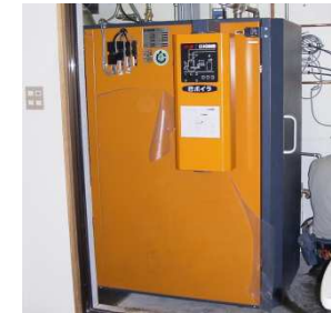
国内発導入のチップボイラー(2001年)
