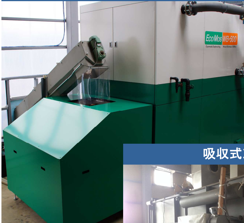
木質チップボイラ
