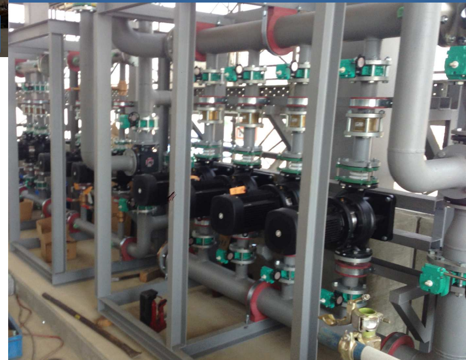
ポンプと配管群
