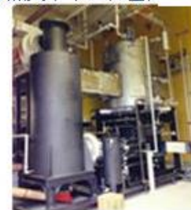
◆蒸気ボイラ(4基)
