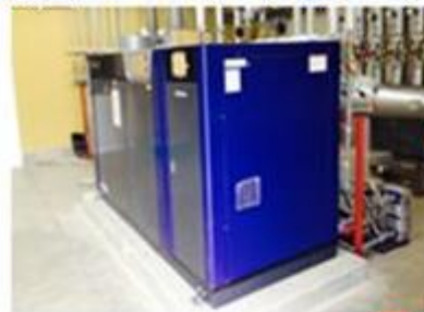
◆蒸気コンプレッサ(1基:75KW)
