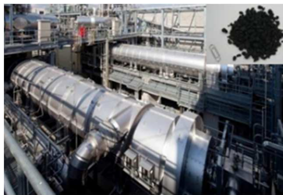
下水汚泥の固形燃料化 (広島市)
