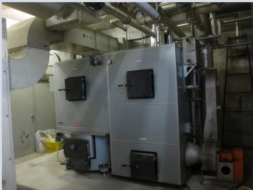
ペレットボイラー2基
