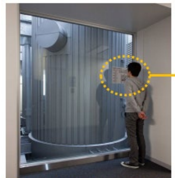
1号館の廊下よりガラス越しに見える縦型蓄熱槽。
