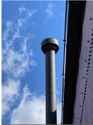
排気の状態は良好燃焼状況必ず確認する。
