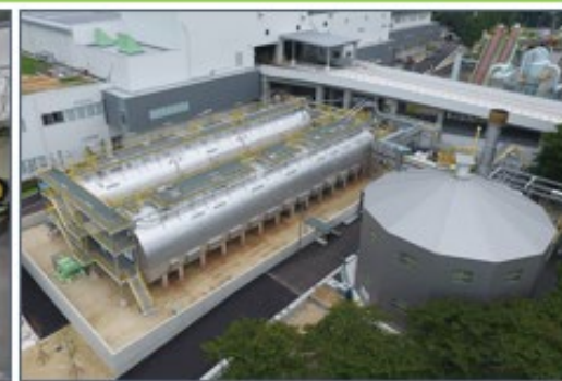
左: 横型乾式メタン発酵槽2基 右: ガスホルダ
