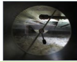
発酵槽の覗き窓より内部の様子
