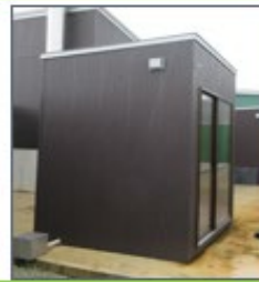
臭気漏れ対策のため攪拌機を建屋で覆っている。
