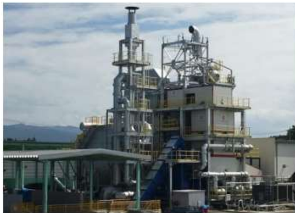
【錦町 2 MW木質バイオマス発電所】
