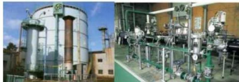
長岡中央浄化センター ガスタンク
