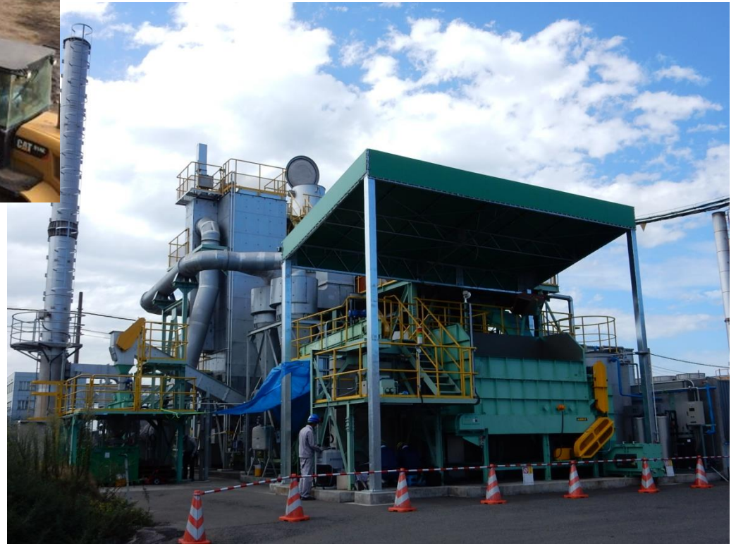
バイオマスボイラー（NEDO事業）
