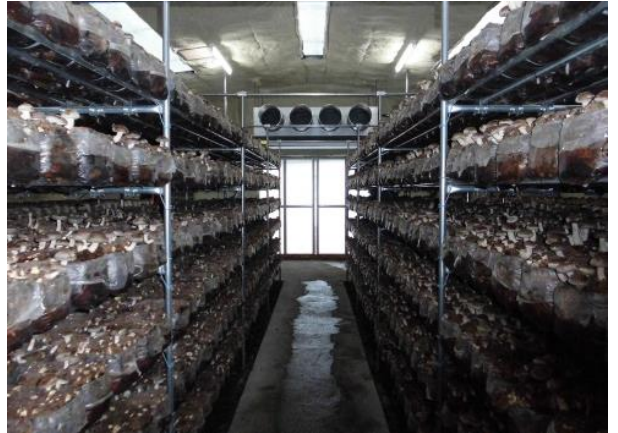
栽培ハウス内部と Fan Coil Unit
