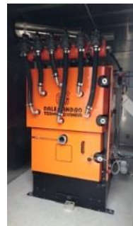
乾燥チップボイラ (施設加熱源)
