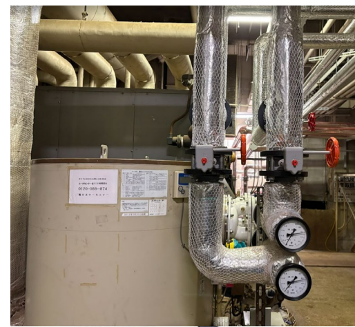
燃料代負担の大きい 重油ボイラー
